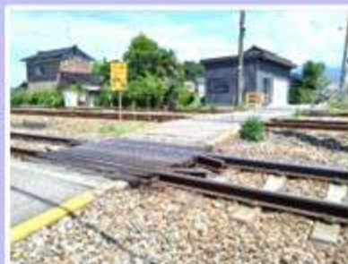
地鉄踏切内の木製段差緩衝材が傷んで いる。児童・生徒がつまずくことがある。
